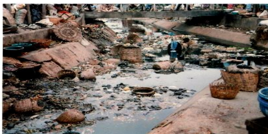
Photo 3 : Un ancien caniveau en dégradation dans le quartier Dantokpa de Cotonou
