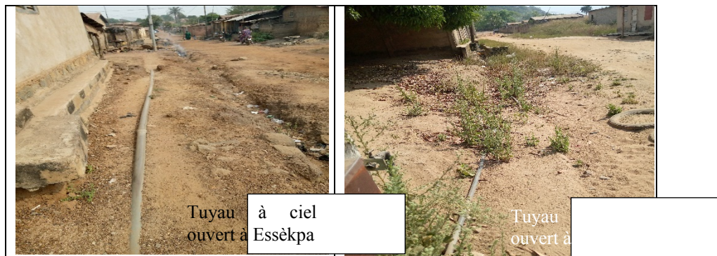
Planche 2 : Equipements de la SONEB mis à nus par l'érosion dans la ville de Dassa
