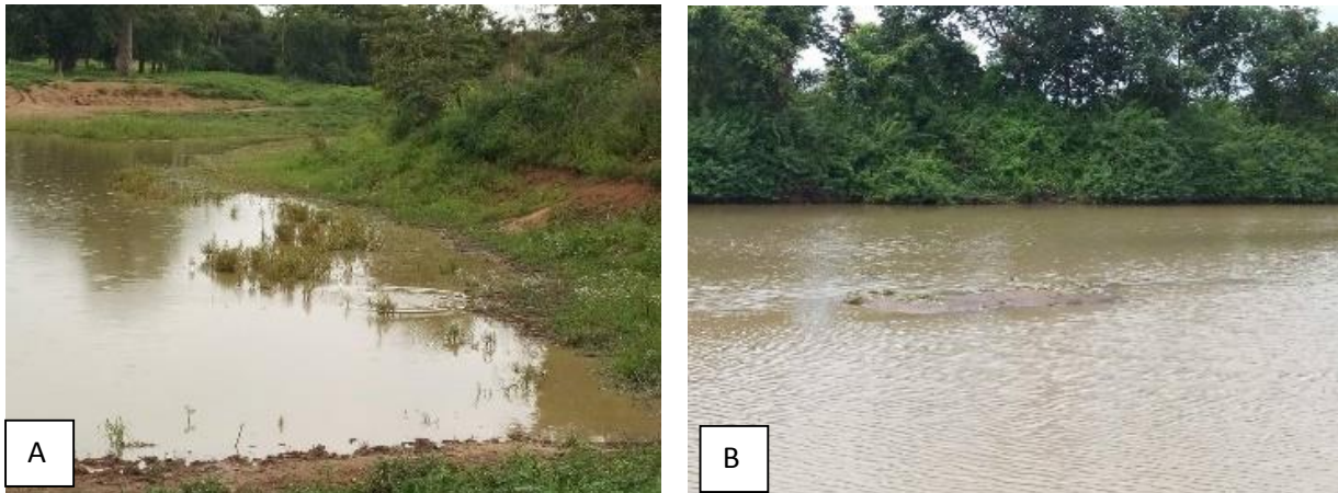
Planche 1 : Etat de digue (A ; B) et cuvette (B) d'une retenue
