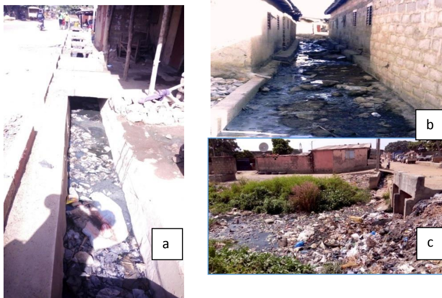
Planche 1 : Caniveaux à ciel ouvert contenant des eaux usées stagnantes mélangées à des ordures à Yébu Béri (a), des Canaux de drainage d'eaux usées et de douche dans des maisons à Ladjifarani (b) et des ponts transformés en dépotoir d'ordure à Zongo-zenon (c).
