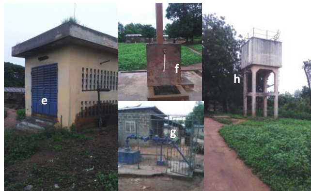
Planche 2 : AEV dans le village de Gobé avec un groupe électrogène (e) ; une pompe immergée (f) ; une borne fontaine installée à Atchapka (g) et un château d'eau (h)
