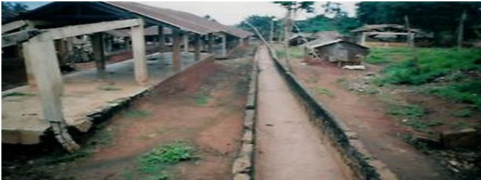
Photo 1: Bâtiments dégradés sous l'effet de l'eau de ruissellement Prise de vue : M. MAKPONSE, Septembre 2017
