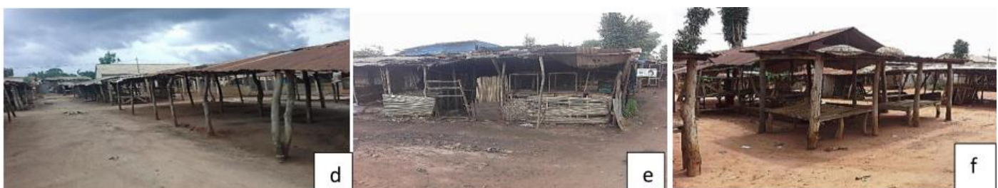
Photo 3: Etat de quelques hangars en matériaux précaires
