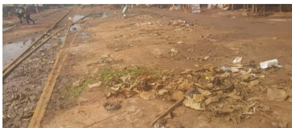
Photo 8 : Etat du marché après une pluie Prises de vue : T.SOSSOU, Septembre 2017
