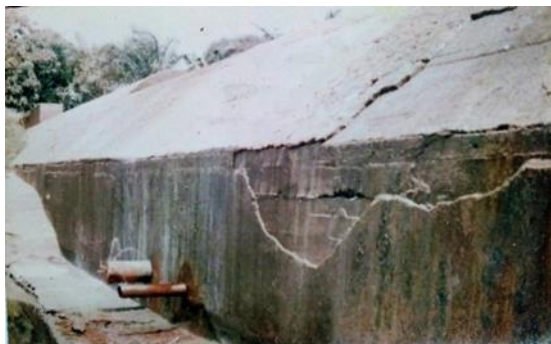
Photo 3 : Enlèvements de plaques de ciment de la digue de Juvé sur Agbado
