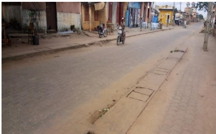
Photo 2 : Vue partielle d'un caniveau à Honmè Prise de vue : Zannou, septembre 2018
