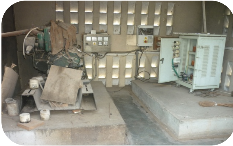
Photo 1: Groupe électrogène qui fait tourner la pompe
