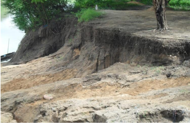
Photo 4 : l'une des berges du fleuve Mono complètement érodée après la grande crue.
