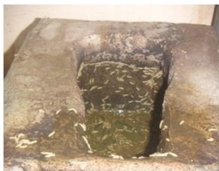
Photo 8 : intérieur insalubre d'une fosse septique à Adjaha (Grand-Popo) (Prise de vue : Sèbo, 2011)
