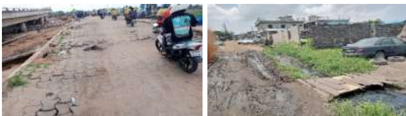
Photo 2 : Ondulations, affaissements de voie pavée et dégradation de voie non revêtue dans des bas-fonds à Cotonou
