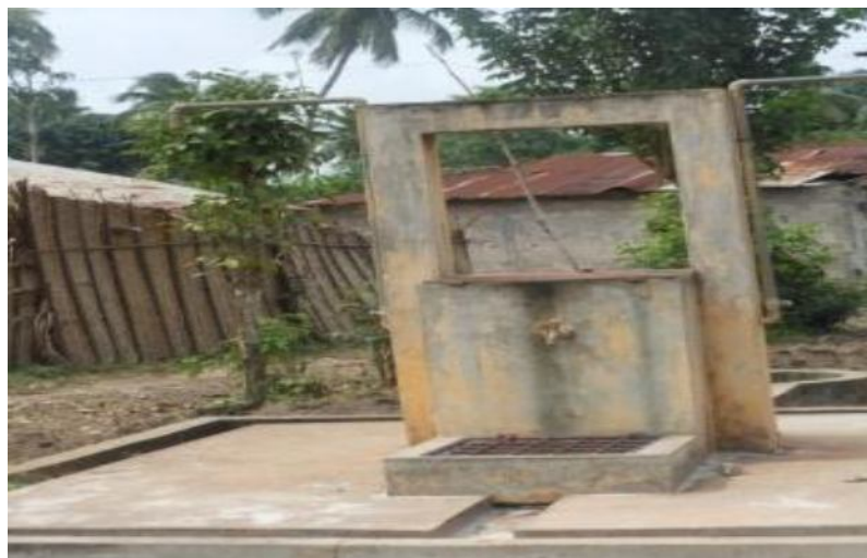
Photo 3 : Forage construit par la direction générale de l'eau Prise de vue : DEGBENOU, Août 2013
