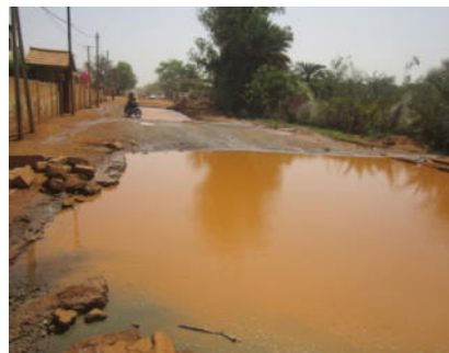
Photo 5 : Rue pavée inondée à Nogaré
