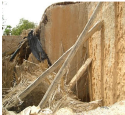
Photo 3 : Une maison en banco effondrée dans le quartier Lamordé
