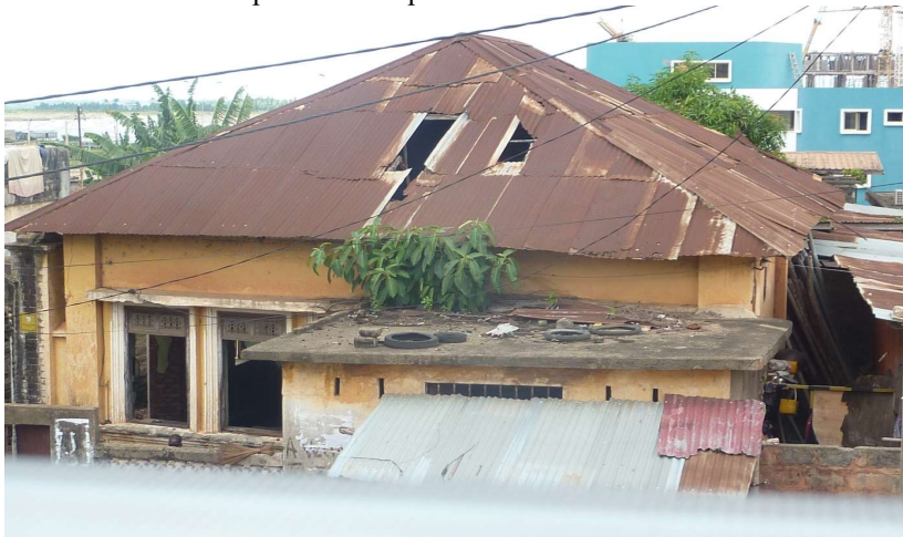
Illustration 5 : exemple de patrimoine immobilier en dégradation (Didier Houénoué 2011)
