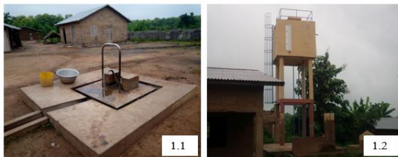
Planche 1 : Pompe à motricité humaine à Godohou et château d'eau à Gbézé
