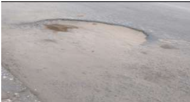
Photo 13 : Route dégradée au niveau de la station ORIX de camp Guézo
