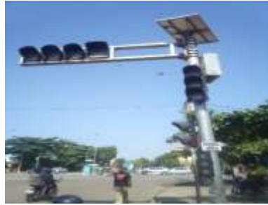
Photo 15 : Feux tricolores non fonctionnels à Houenoussou
