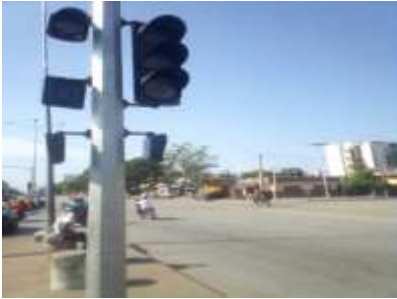
Photo 14 : Feux tricolores non fonctionnels à Akpapa Sodjatinmè
