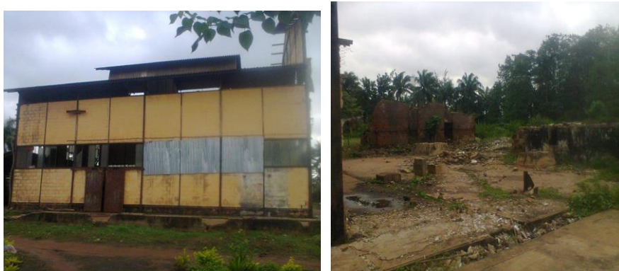
Photo 1 et 2 : Huilerie de Gbada en état de ruine Source : Cliché AFFOMAÏ, mars 2014.
