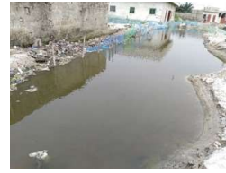
Photo 21 : Fouille mal balisée sur rue 13.385 Petit à Petit 1 à Agla
