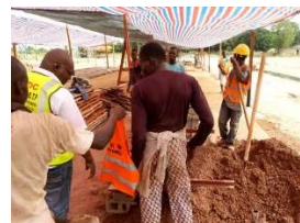
Photo 18 : Non port d'EPI par un ouvrier
