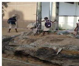
Photo 9 : fouille mal balisée sur la rue 12437 à côté de EPP Jacquot
