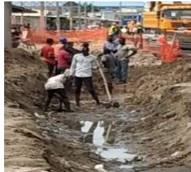
Photo 15 : Ouvriers travaillant sans EPI sur la rue 13.487 pharmacie Akplomey
