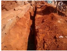
Photo 19 : fouille non balisée sur la rue 11.006 à Gbégamey
