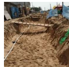
Photo 26 : Passerelle sans garde-corps sur la rue 12.303 en face des rails d'Aïbatin
