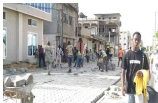
Photo 17 : Ouvriers n'ayant pas porté leurs EPI rue 12.437 von en face pharmacie la Madone
