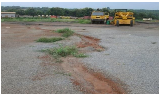
Photo 3: Ravin au nord-ouest du site étudié Prise de vue : Aïdonougbo, mai 2015
