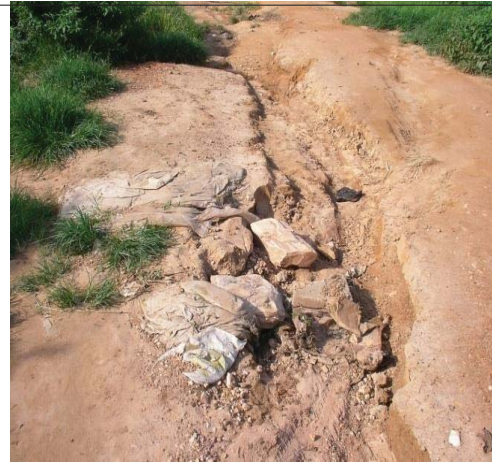
Photo 2 : Ravinement d'une rue vers le quartier Bourgnon
