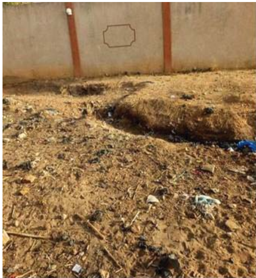
Photo 3. Clôture de maison menacée par l'érosion pluviale
