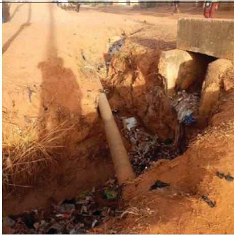
Photo 1 : Dégradation des ouvrages urbains par l'érosion pluviale à Lomé
