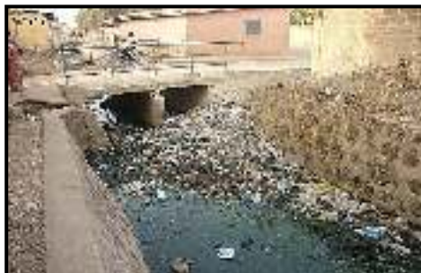
Photo 1 : Dépotoir d'ordure à l'intérieur d'une canalisation à Baparapei (Djougou). Prise de vue : Ouorou, Mai, 2016
