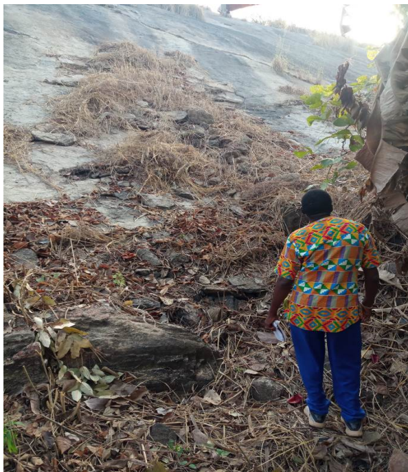
Photo 13 : Eboulement d'une partie de la muraille en pierre sèche (non bien appro Source : Travaux de terrain, décembre 2020
