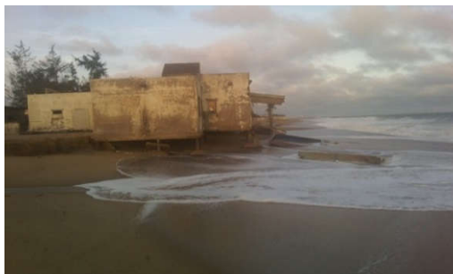
Photo 2 : Bâtiment sous la menace de l'érosion à l'est de l'épi 1 Prise de vue : HOUNSOU, Septembre 2015
