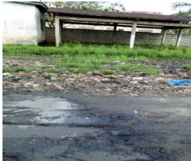
Photo 1 : Remblai des voies avec déchet à Atchannou
