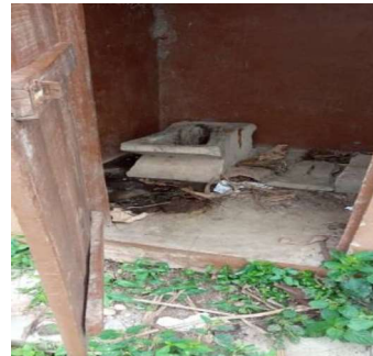
Photo 2 : Etat des WC qui sont par la suite inondés
