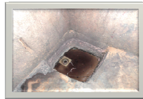
Photo 5 : Fosse non étanche recueillant les eaux usées de l'atelier de teinturerie à Tankpè. Cliché DOVONOU F. 2010
