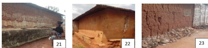
Photo 21, 22 et 23 : Construction de terrasses ou murettes et groupage de pierre contre l'érosion pluviale
