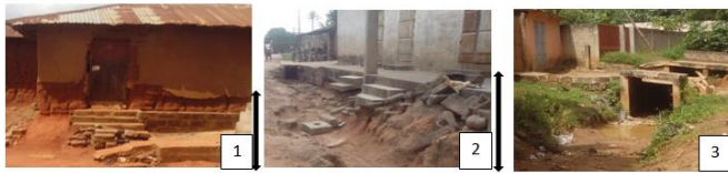
Photo 1 : Déchaussement d'une maison à Dahoué
