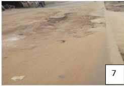
Photo 7 : Dégradation la voie bitumée
