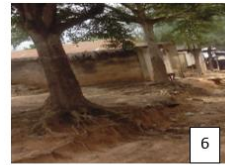
Photo 6 : Arbre déchaussé à Dahoué
