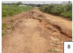
Photo 8 : Dégradation de la voie de Madjrè
