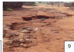
Photo 9 : Dégradation de la voie de Lokogohoué
