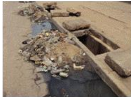
Photo 4 : Composition des déchets issus des caniveaux fermés à Agla
