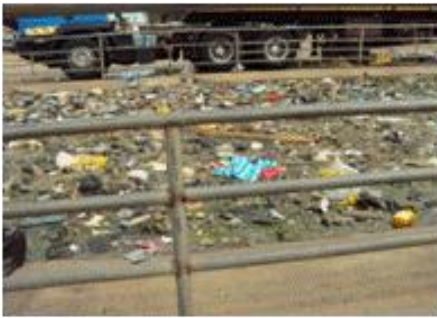
Photo 3 : Caniveau à ciel ouvert jonché de déchets à Aidjèdo
