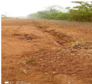
Photo 5 : dégradation par excavation
