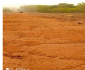
Photo 6 : dégradation par escaliers
