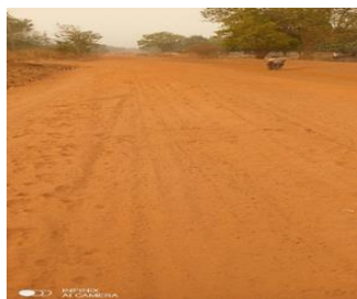
Photo 4 : dégradation par boue (Kouandé-Péhunco)
