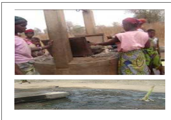
Photo 8 : Insalubrité autour du puits à grand diamètre construit par la SNV à Gnel Djaouga/Nikki Cliché : Afoudah et Hédibè, Février 2010
