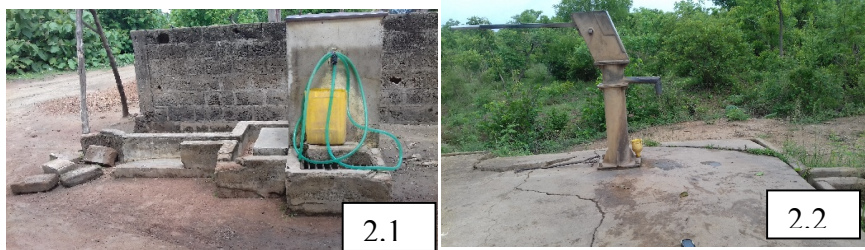
Planche 2 : Un robinet à Bamè (2.1) et pompe à motricité humaine à Klougo (2.2)
