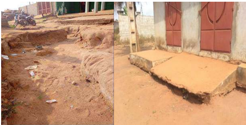
Figure 7. Ruelle détruite par une ravine à Tanto Porto-Novo (à gauche) et déchaussement d'un système de protection par l'érosion à Vakon Akpro-Misséré (à droite) (Clichés : Eténé, juin 2019)
