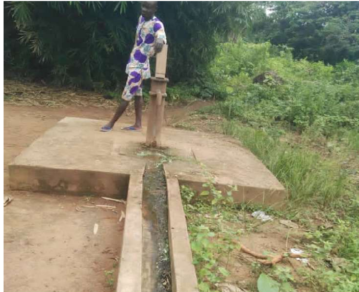
Photo 1 : FPMH en panne à Gbégoudo,
