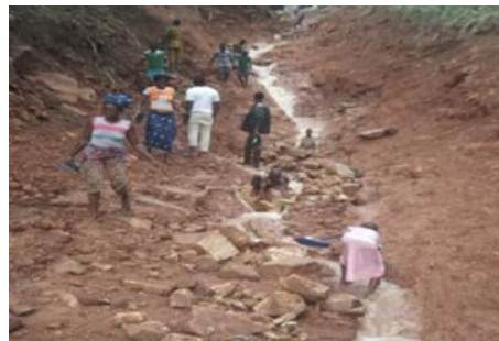
Photo 11: Tranchée créée par solifluxion sur un versant de la colline de Savalou
