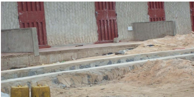
Photo 2 : Caniveaux d'évacuation des eaux de ruissellement dans le marché de Dassa-Zoumé.
