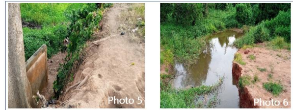
Photo 5 : Érosion des sols à proximité d'une canalisation de voie menant à la dépression de Louho (6°28'32"N et 2°35'29"E).
