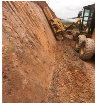
Photo2: Modification des formations géologiques
