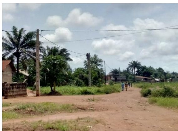
Photo 2 : Image du réseau électrique à Ouanho-centre Prise de vue : Zannou, août 2019
