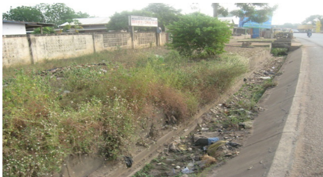
Photo 4 : Caniveaux remplis de déchets devant le centre de santé de Glazoué Prise de vue Détondé, Janvier 2018
