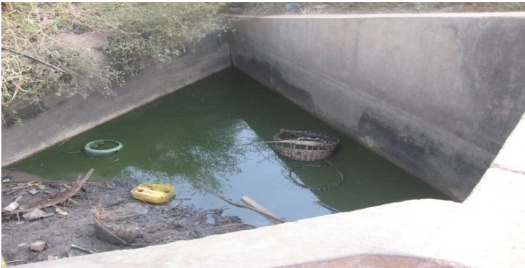
Photo 3 : Eau stagnante dans un ponceau au quartier Affécia (Glazoué)
